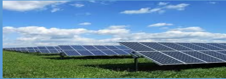
Centrale PV installatie
